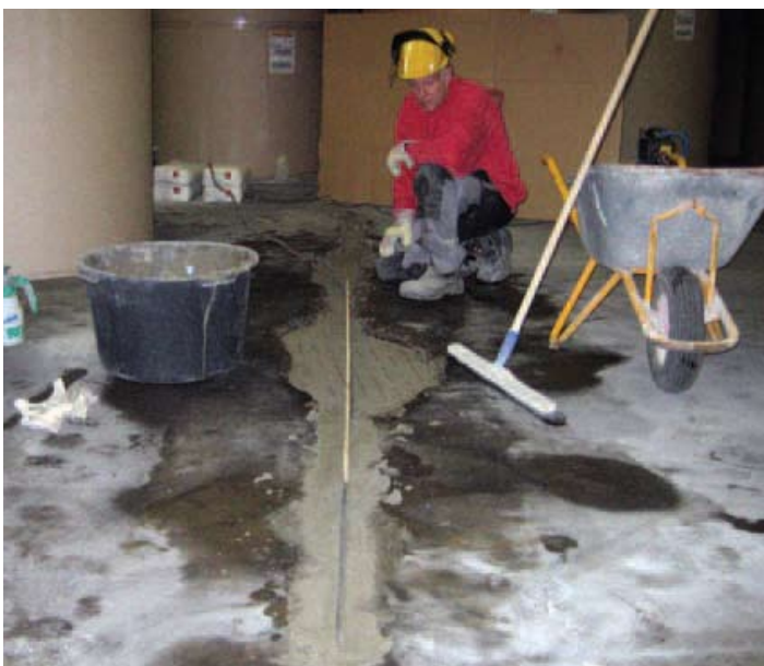
Skadade fogkanter renoverade
